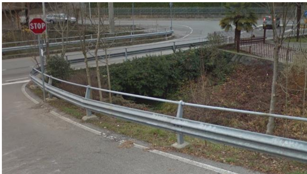
Figura 6 - Nese, attraversamento Torrente Nesa in via Busa
