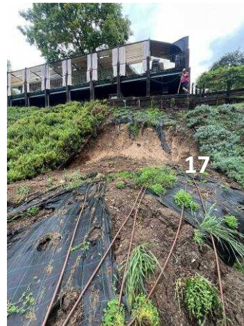
Foto 4.39 Frana n. 17 – frana attiva
