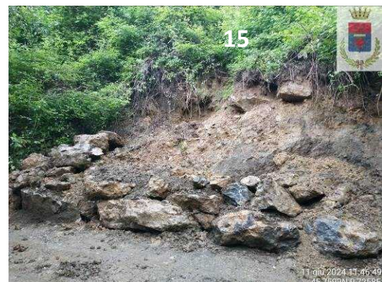
Foto 4.35 Frana n. 15 – frana attiva
