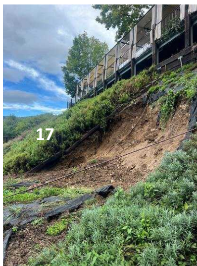
Foto 4.40 Frana n. 17 – frana attiva
