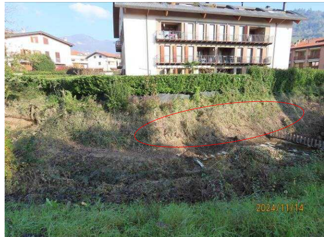
Foto 4.104 Vista della scarpata in sinistra idrografica del torrente che è stato erosa (cerchio rosso)
