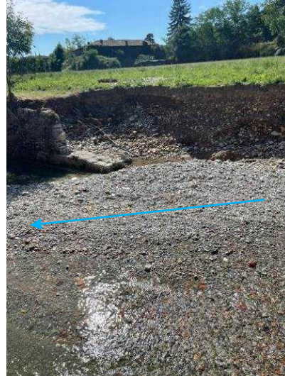
Foto 4.76 Argine del Torrente Nesa in destra idrografica del Torrente Nesa in corrispondenza di Via Licini
