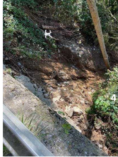
Foto 4.5 Frana n. 4 – frana attiva
