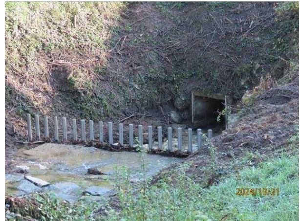
Foto 4.102 Vista dell'imbocco del tratto intubato sottodimensionato
