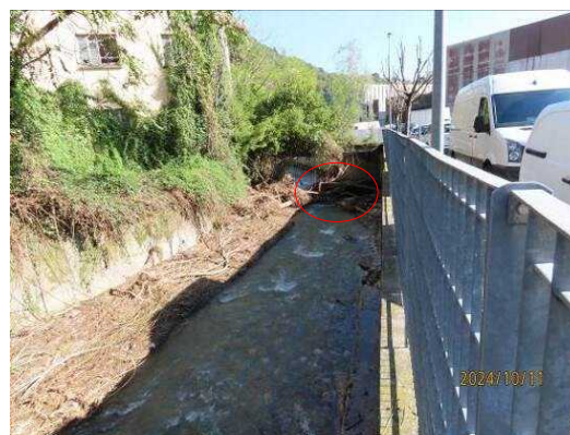
Foto 4.98 Vista della passerella posta più a monte dove si nota la presenza di tronchi di piante accumulati alla base (cerchio rosso)
