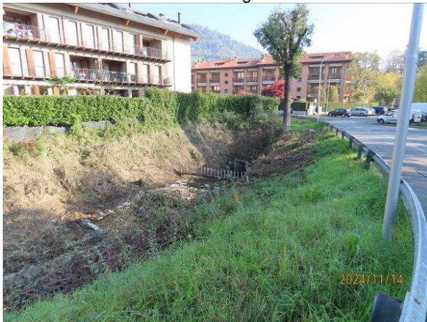
Foto 4.103 Vista del torrente che è stato ostruito da materiale vegetale
