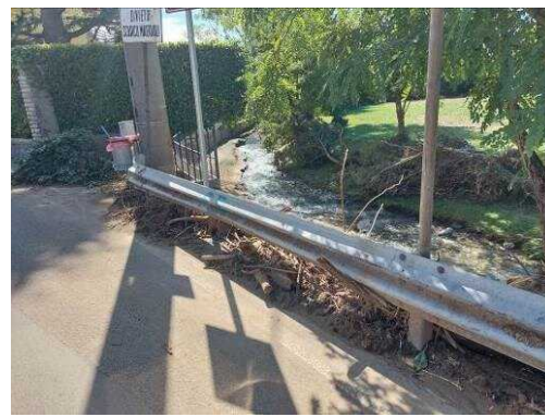
Foto 3.74 Vista di Via Licini in sponda sinistra del Torrente Nesa dove si nota presenza di legname depositato dal torrente
