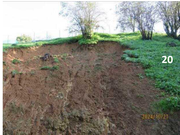
Foto 3.45 Frana n. 20 – frana attiva
