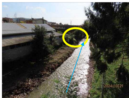
Foto 3.68 Rottura argine in sponda idrografica del Torrente Nesa (freccia azzurra)
