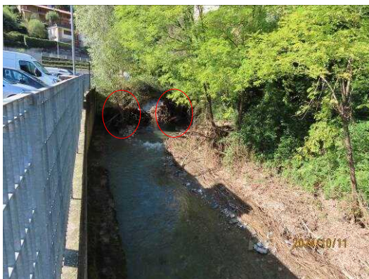
Foto 3.97 Vista della passerella sul Torrente Nesa posta più a valle dove si nota materiale grossolano e legname accumulato (cerchi rossi)
