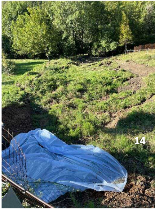
Foto 3.28 Frana n. 14 – frana attiva vista dalla strada verso valle
