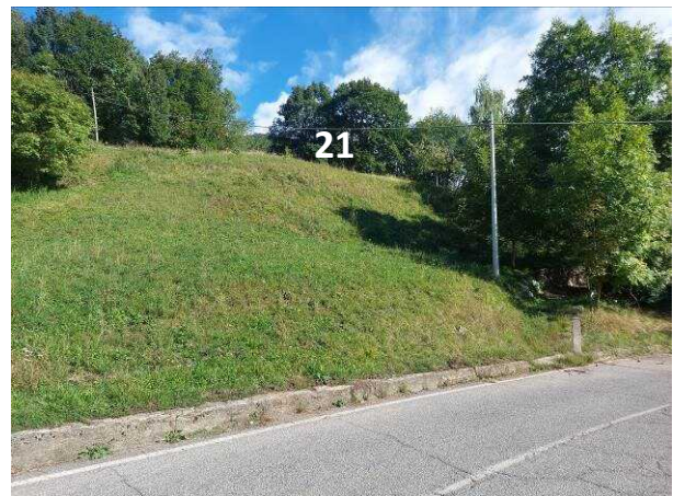
Foto 3.51 Frana n. 21 – frana quiescente
