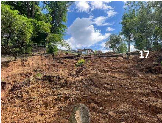
Foto 3.38 Frana n. 17 – frana attiva
