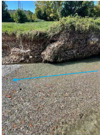
Foto 3.77 Argine del Torrente Nesa in destra idrografica del Torrente Nesa in corrispondenza di Via Licini
