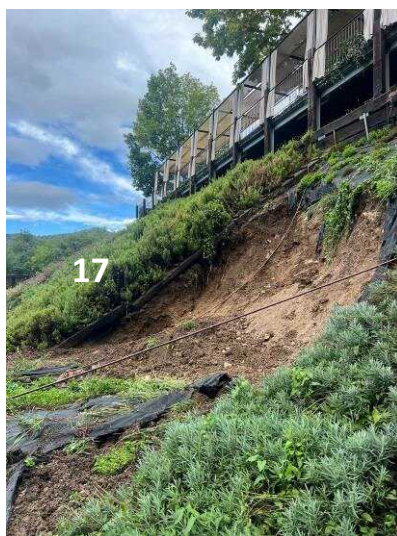
Foto 3.40 Frana n. 17 – frana attiva
