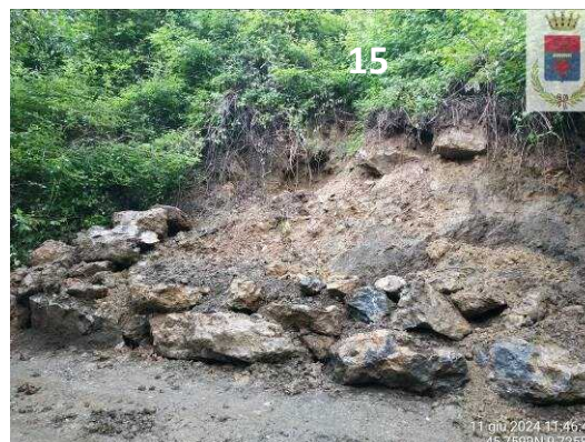
Foto 3.35 Frana n. 15 – frana attiva
