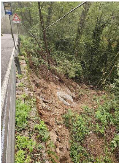
Foto 3.6 Frana n. 4 – frana attiva
